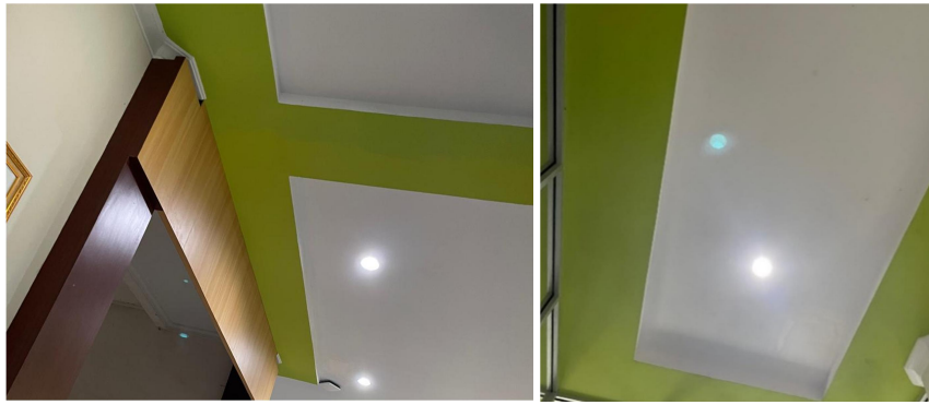
Gambar 6 Kondisi plafon eksisting
