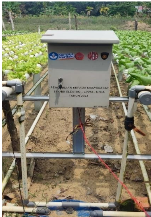
Gambar 12 Panel kontrol yang telah dirakit
